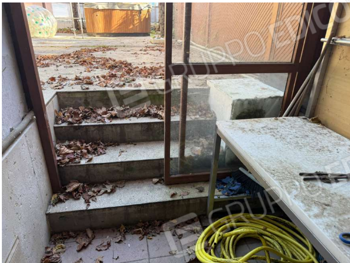
Foto 21: DIFFORMITÀ - Scala di accesso al vano seminterrato
