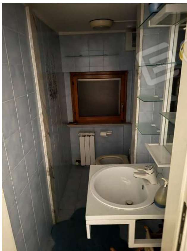
Foto 24: DIFFORMITÀ - Bagno aggiuntivo non autorizzato
