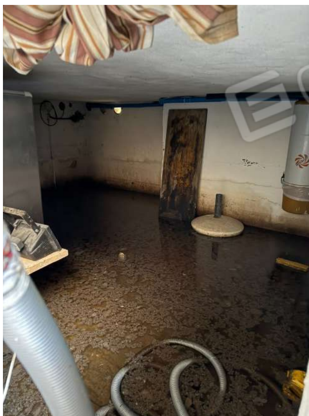
Foto 26: DIFFORMITÀ - Locale seminterrato allagato
