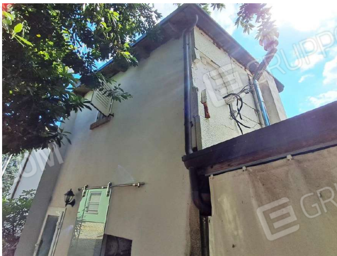
PROSPETTO LATO EST E LATO NORD SUL QUALE NON RISULTA COMPLETATA LA POSA DEL CAPPOTTO ISOLANTE
