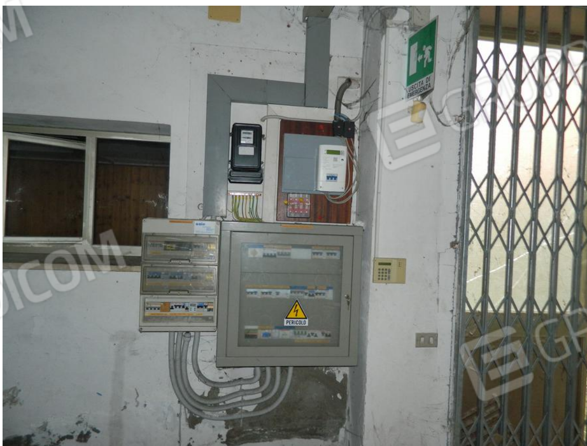
FOTO 20– Impianti a piano seminterrato
