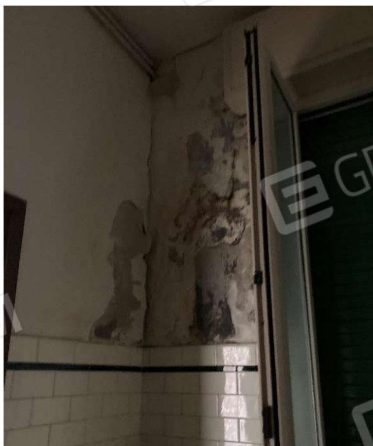
Infiltrazione di acqua nell'angolo del bagno.
