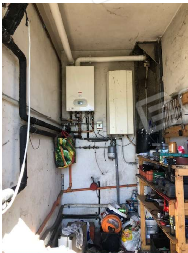
Foto 9 – centrale termica sub 4
