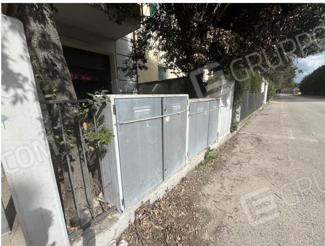
Contatori posti sulla recinzione esterna fronte strada
