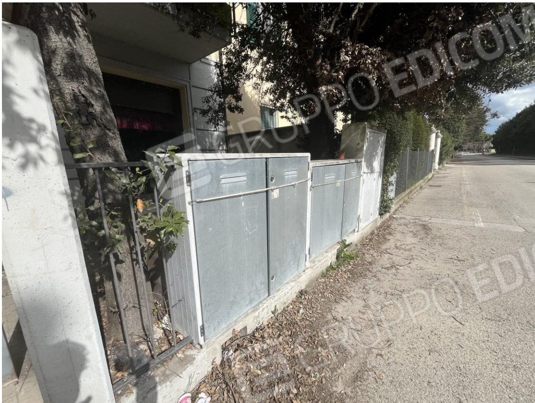
Contatori posti sulla recinzione esterna fronte strada
