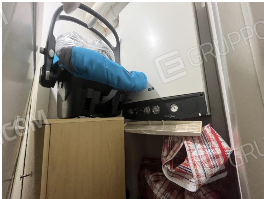
Caldaia posta nel disimpegno
