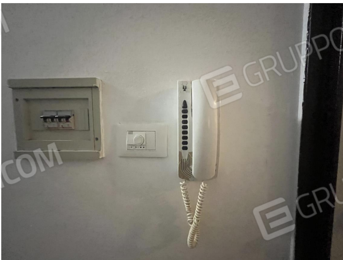
Quadro elettrico, termostato e citofono posti nell'ingresso
