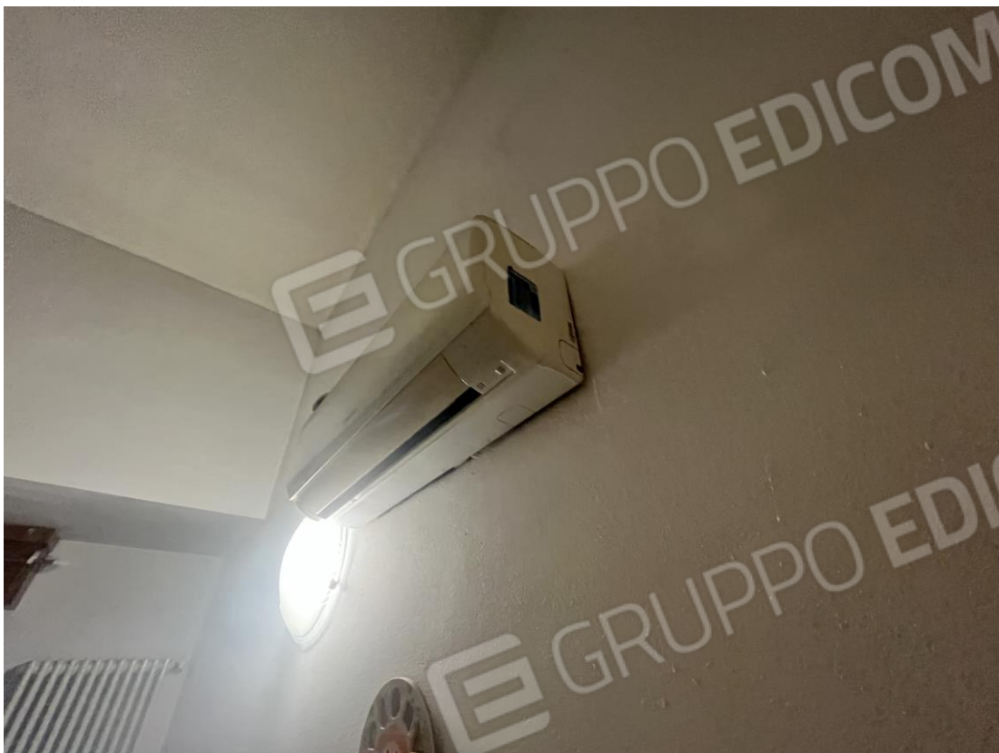
Split condizionamento posto nel vano ufficio
