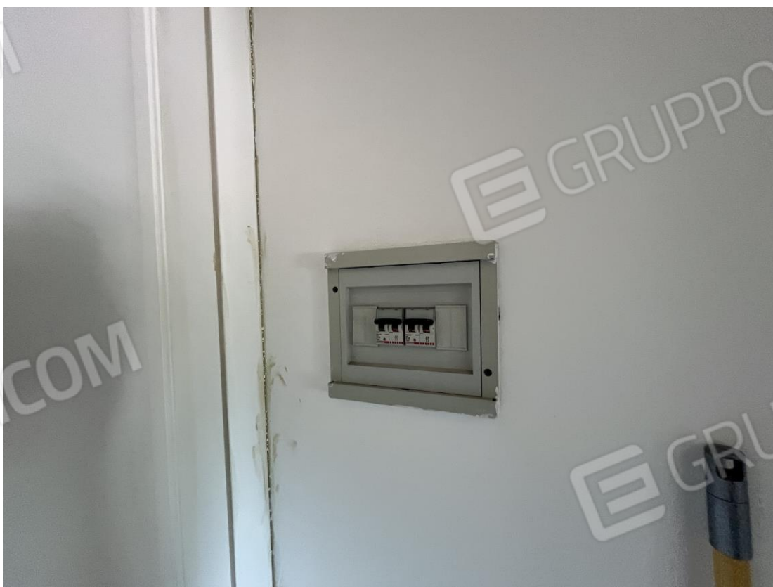
Quadro elettrico posto nel disimpegno
