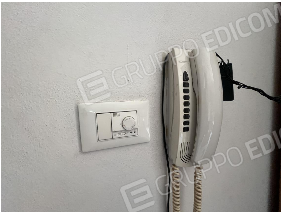
Termostato e citofono posti nell'ingresso
