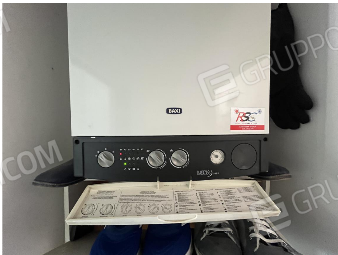
Caldaia posta nel disimpegno
