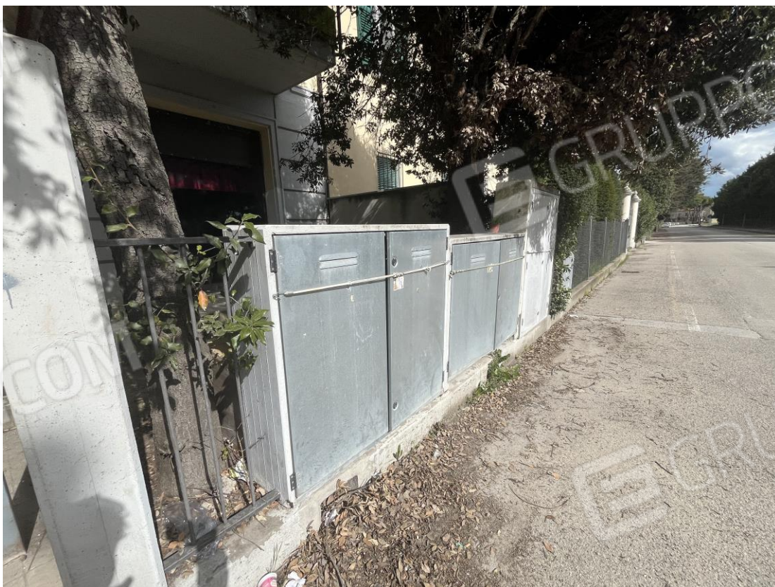
Contatori posti sulla recinzione esterna fronte strada
