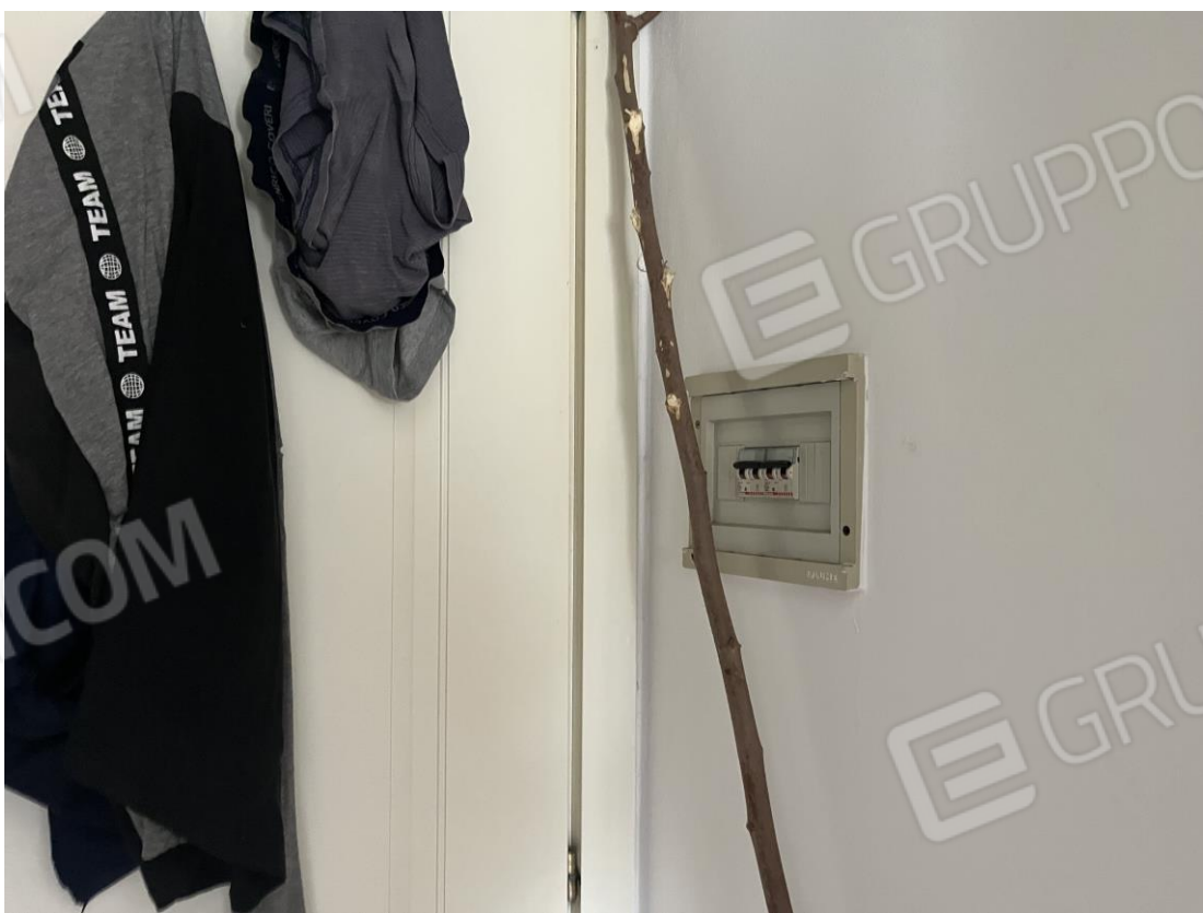
Quadro elettrico posto nel disimpegno
