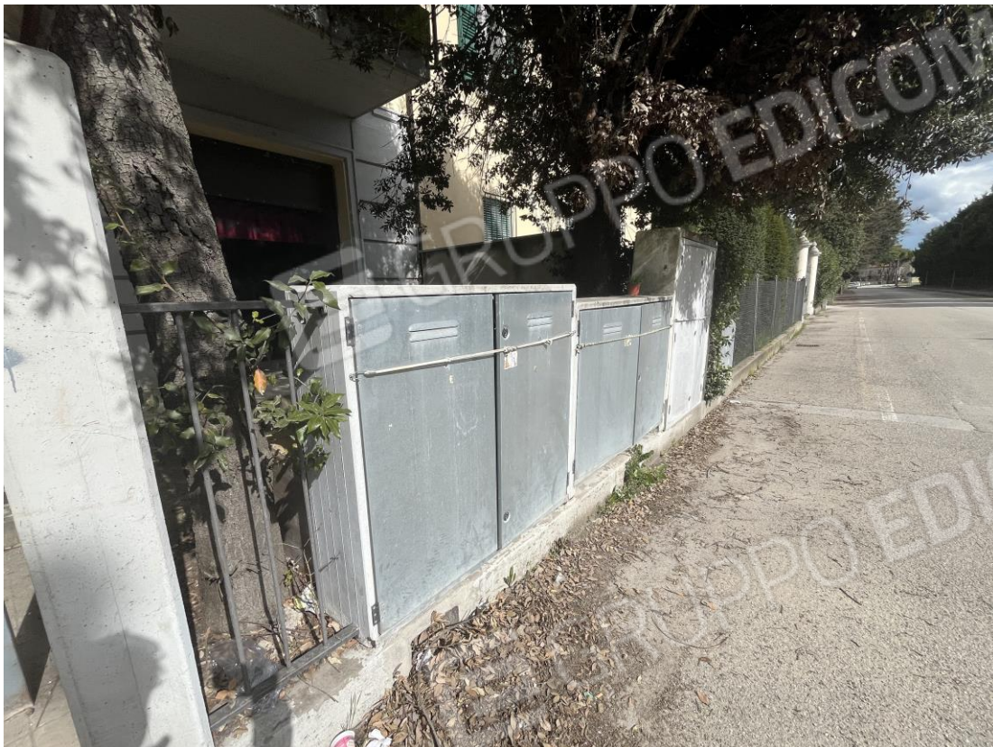
Contatori posti sulla recinzione esterna fronte strada
