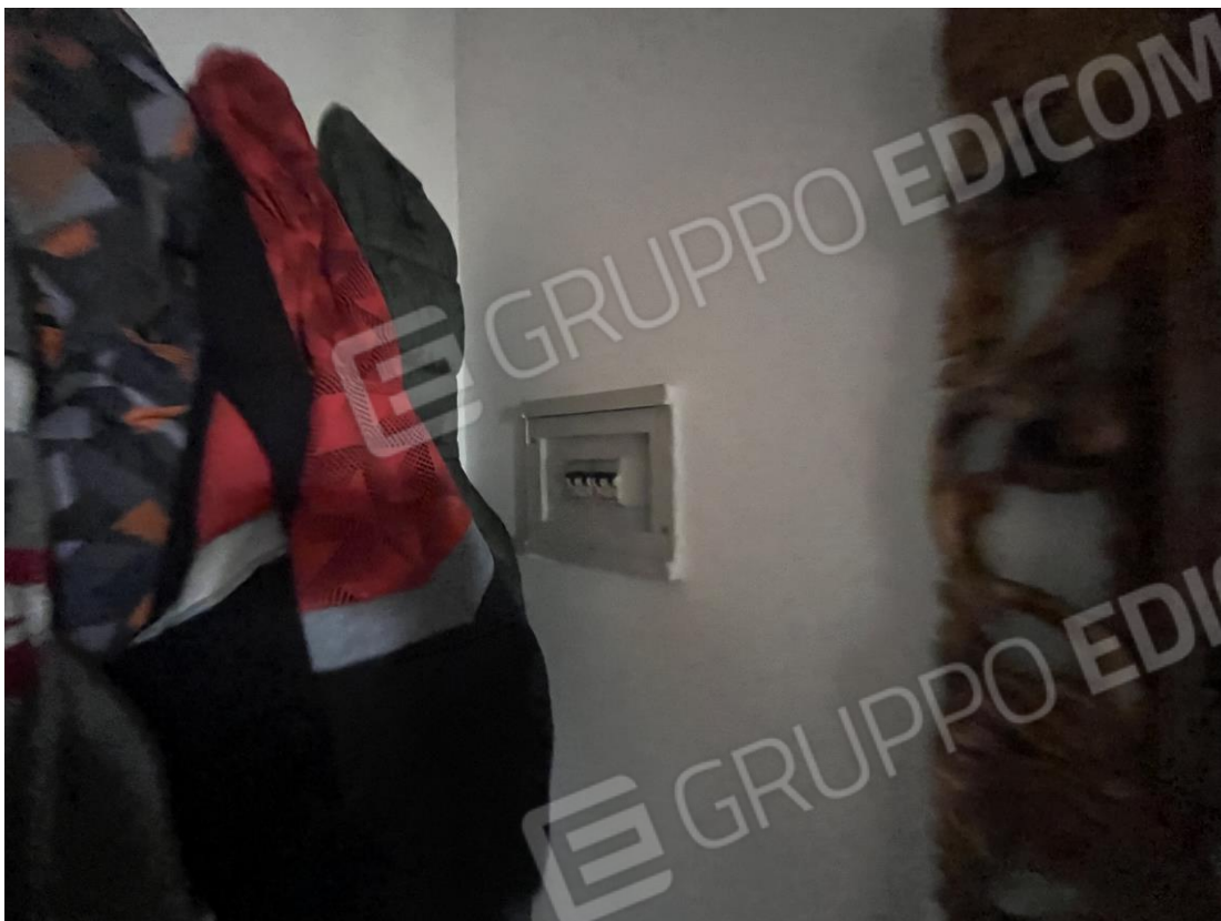
Quadro elettrico posto nell'ingresso
