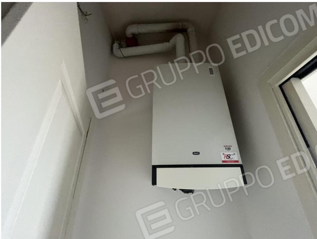
Caldaia posta nel disimpegno
