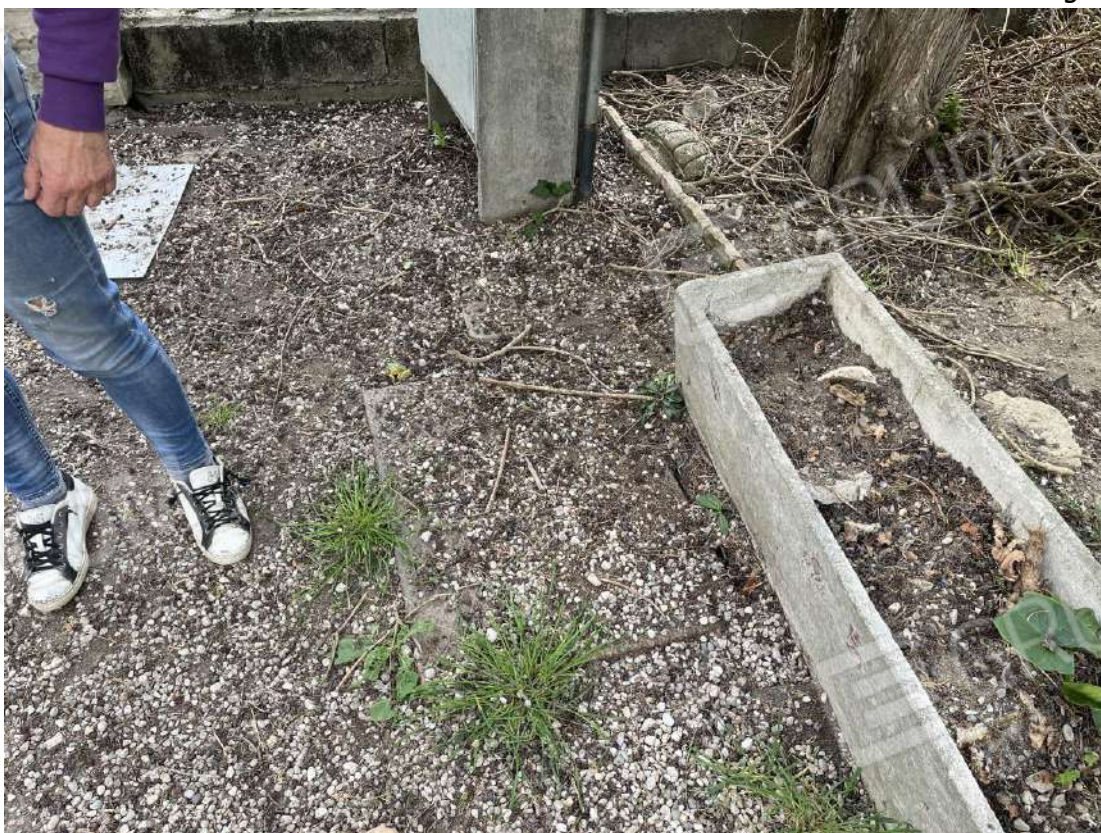
Contatore acqua adiacente ad armadietto gas
