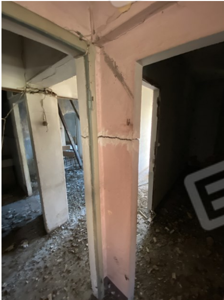
Sub. 13 – particolare crepe P1 (foto 1)
