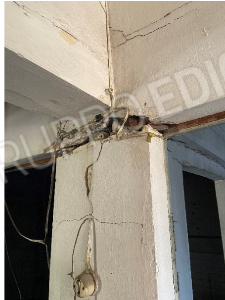
Sub. 13 – particolare crepe P1 (foto 2)
