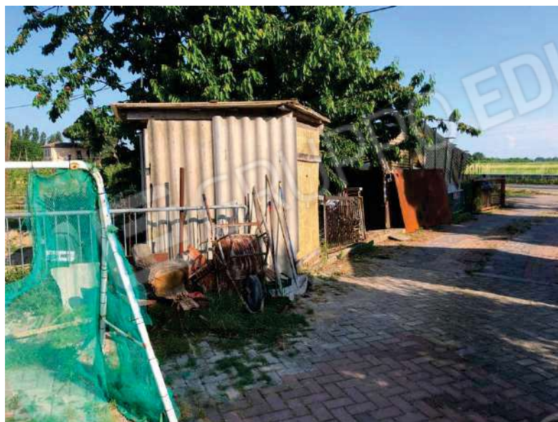
Foto 64 struttura precaria da demolire
