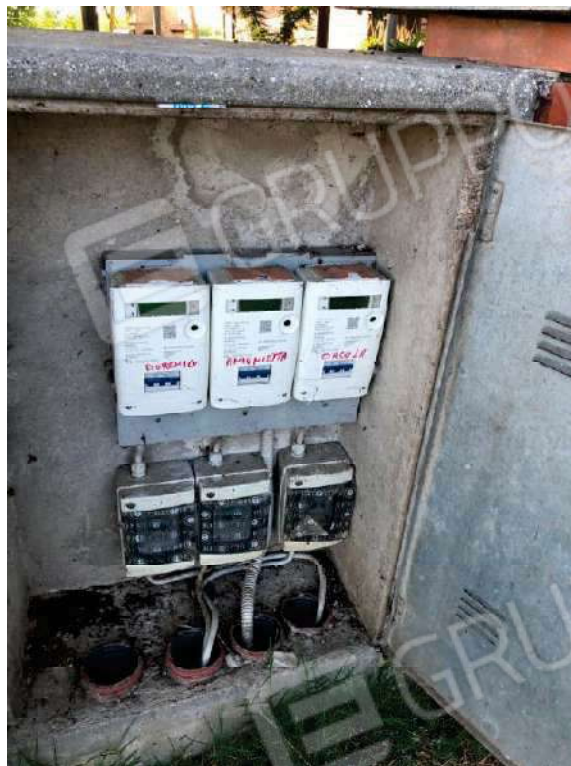
Foto 62 contatori energia elettrica
