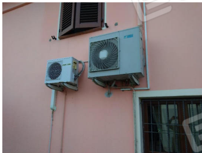
17. Unità esterne condizionatori
