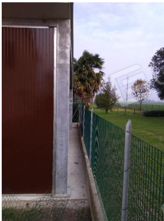
19. Struttura tettoie abusive
