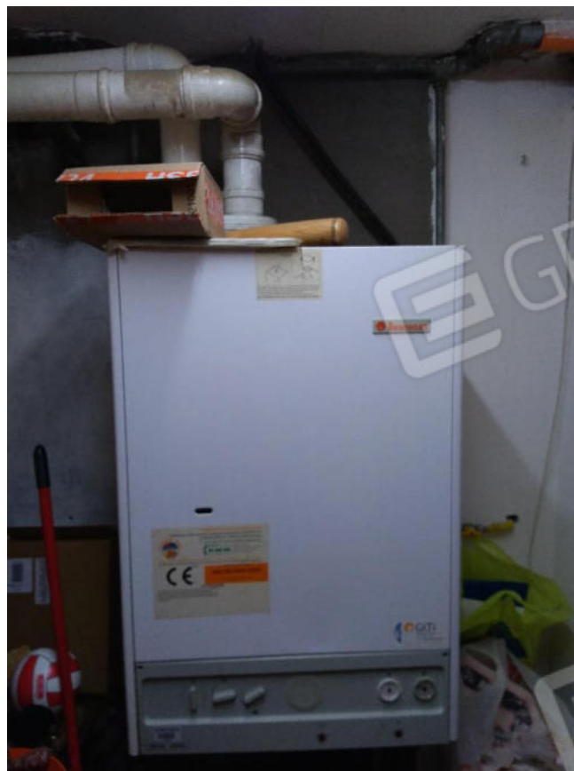
15. Caldaia murale tipo C
